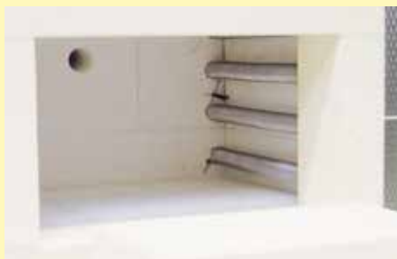
Interior del horno con aislamiento de ladrillos refractarios de alta calidad
