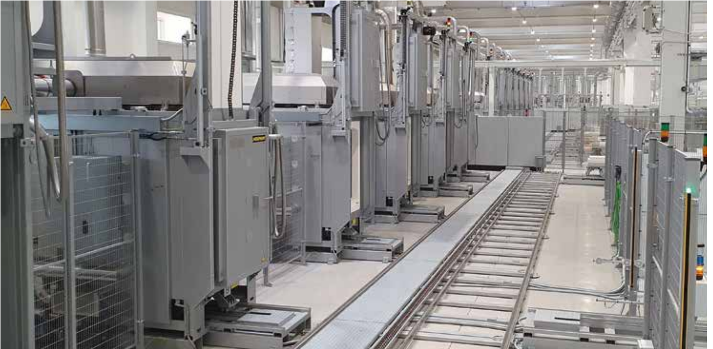
配备6个组合式台车炉W 2254/14 DB200-3和用于交替式运行的催化后燃烧装置的窑炉设备、升降门以及适用于自动运行的带装料/卸料工位的转移系统
