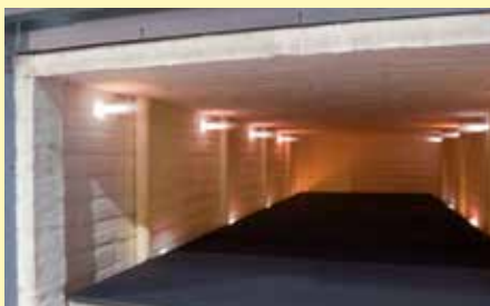
带有8个高速燃烧器的炉膛
