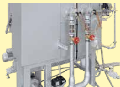
带两个燃烧器的燃气管道位于炉后壁
