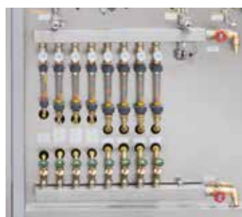
Enfriamiento mediante distribución de agua
