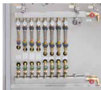
Rozvod chladicí vody
