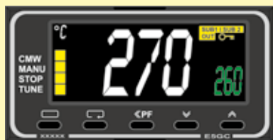
Régulateur de sécurité de surchauffe
